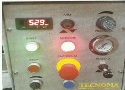
PANNELLO CON INVERTER
